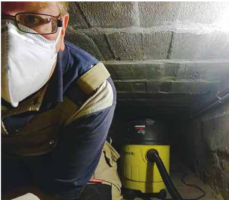
Hier sehen Sie unseren Küster Peter Niehuss im vollen Einsatz unter dem Fußboden der Jakobikirche. Die Heizungskanäle brauchen eine gründliche Reinigung.
